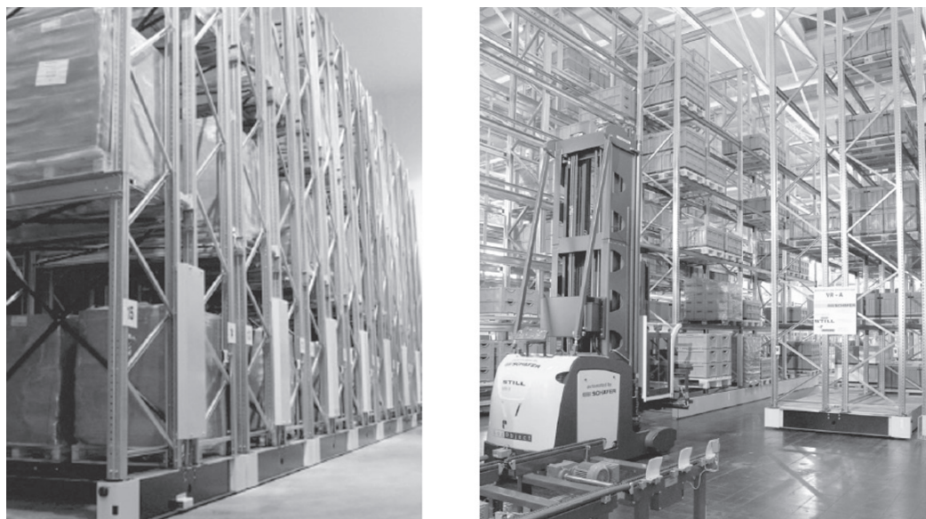
Rys. 4.3. Magazyn przejezdny: a) regały przejezdne, b) automatyczne regały przejezdne z wózkiem sterowanym laserowo [46].
