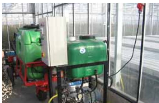
10. Urządzenie do podnoszenia ciśnienia w instalacji wodnej do zamgławiania
