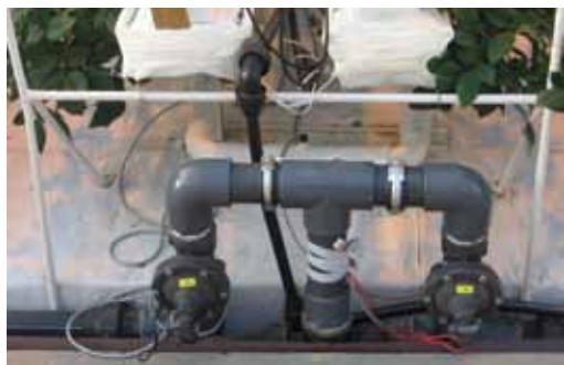
4. Fragment instalacji nawodnieniowej – zawory sterujące
