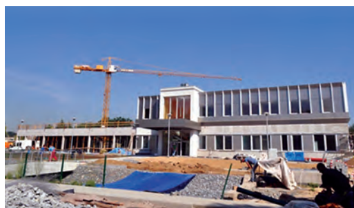
Fragmenty budynku stanowiska gantry budowanego w ramach II fazy projektu Narodowe Centrum Radioterapii Protonowej – Centrum Cyklotronowe Bronowice (30.08.2012)
