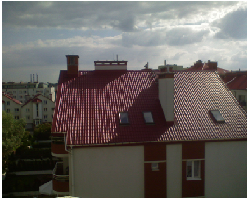
Rys. 16. Zwody pionowe nad kominkami i metalowe pokrycie dachu jako elementy instalacji odgromowej na budynku mieszkalnym
