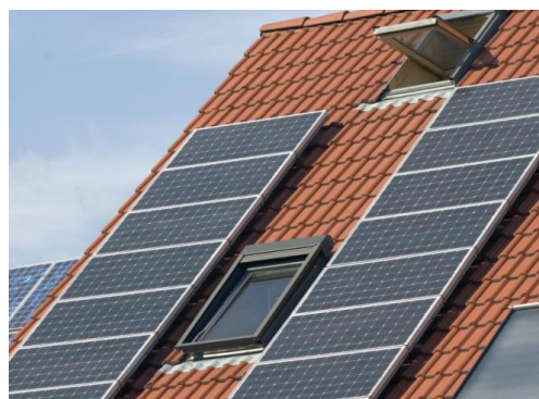
Rys. 150. Kolektory słoneczne zamontowane na dachu budynku
