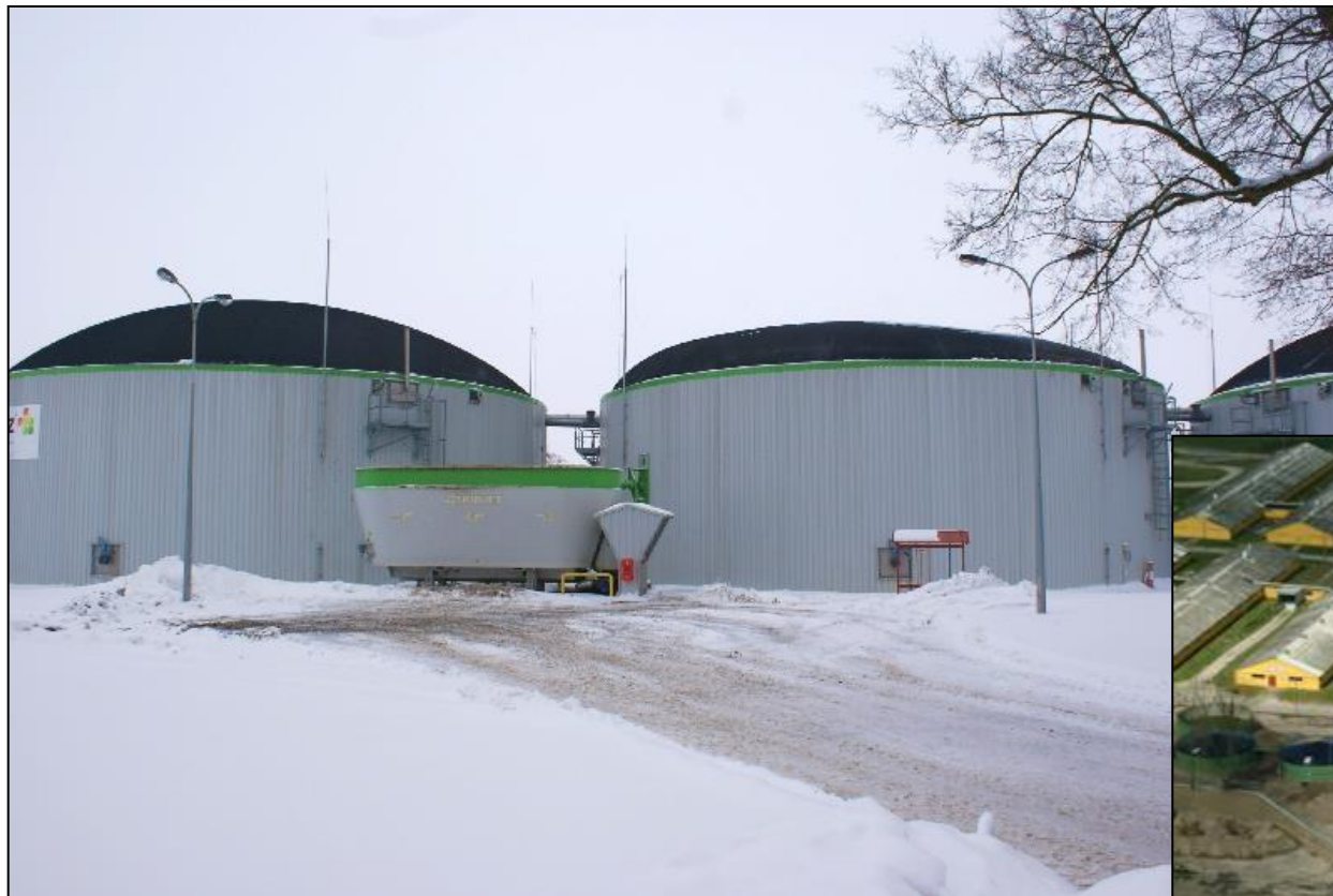
Biogazownia w Liszkowie
