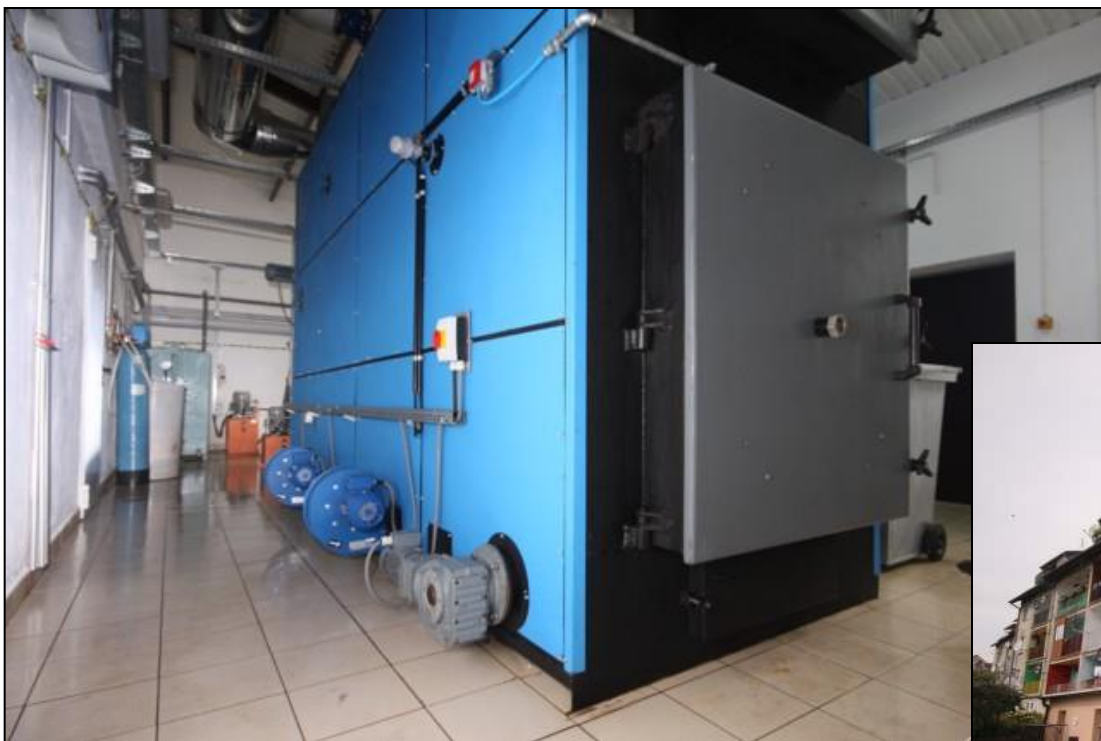
Kotłownia w Barcianach
