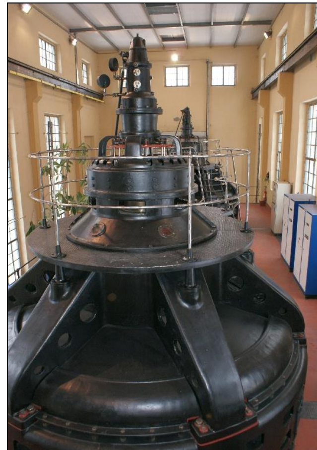
Elektrownia Żur – hala generatorów
