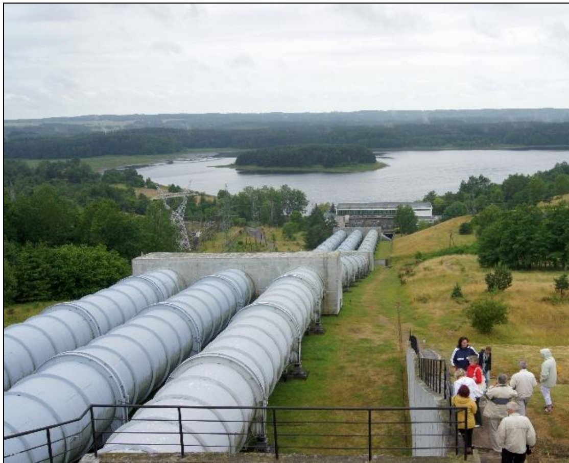
Elektrownia pompowa – szczytowa w Żydowie
