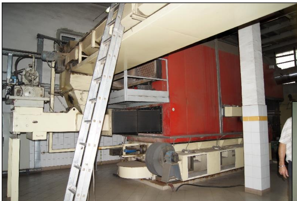
Osiedlowa kotłownia w Karwicach
