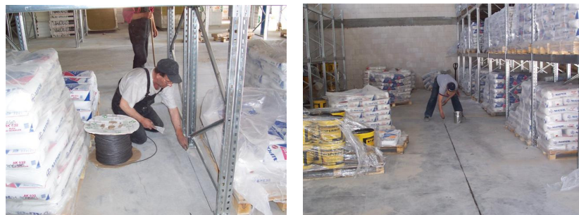
Rys.6.23. Pracownik umieszczający w szczelinie skurczowej sznur rozprężny, a następnie wypełniający szczelinę skurczową masą uszczelniającą. Źródło własne
