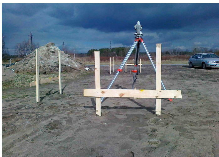
Zdj. 33, 34, 35. tyczenie obiektu w terenie Obsługa geodezyjna montażu hali (majster, technik budowy wyposażeni w tachimetr (teodolit), niwelator z łąką)
