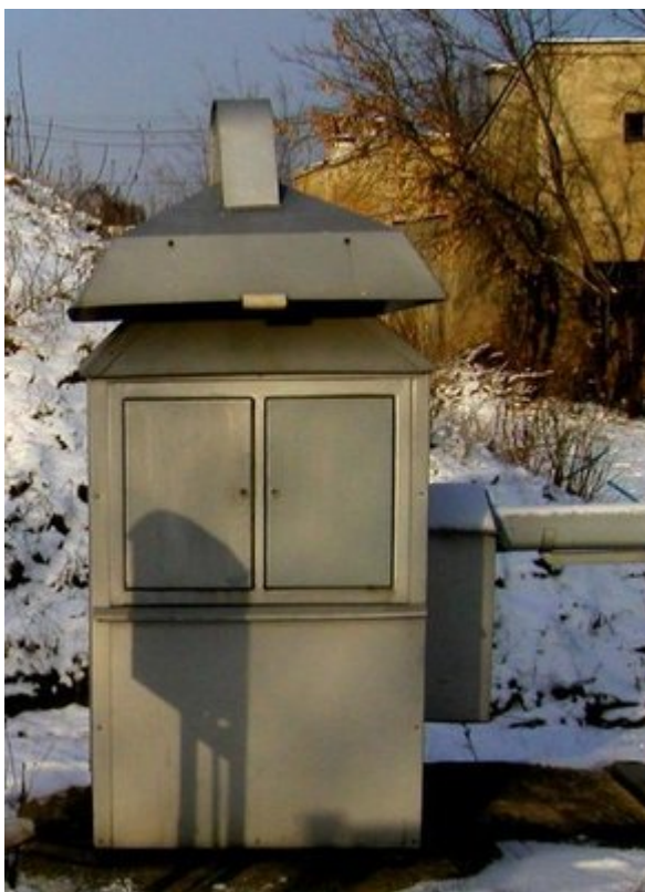
Rysunek 3.108: Stacja monitoringu ASS-500 w CLOR
