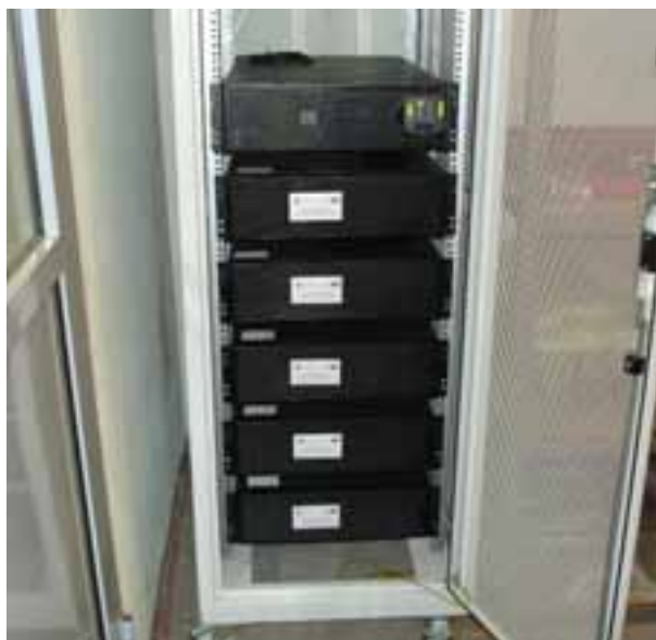
Rys. 5.3 - Główny zasilacz rezerwowy wraz z bateriami zasilający serwery projektu.
