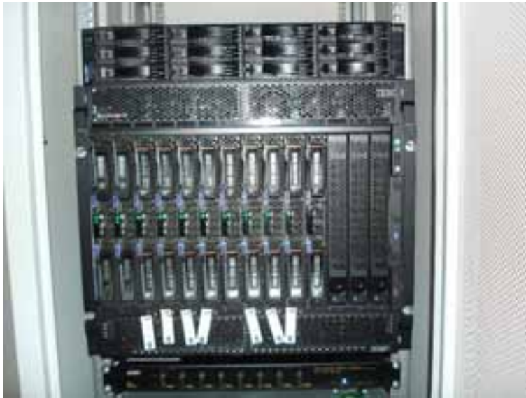
Rys. 5.2 - Serwery projektu oraz macierz dyskowa. Z przodu widoczne są serwery, przełączniki sieciowe i Fibre Channel są umieszczone z tyłu obudowy.
