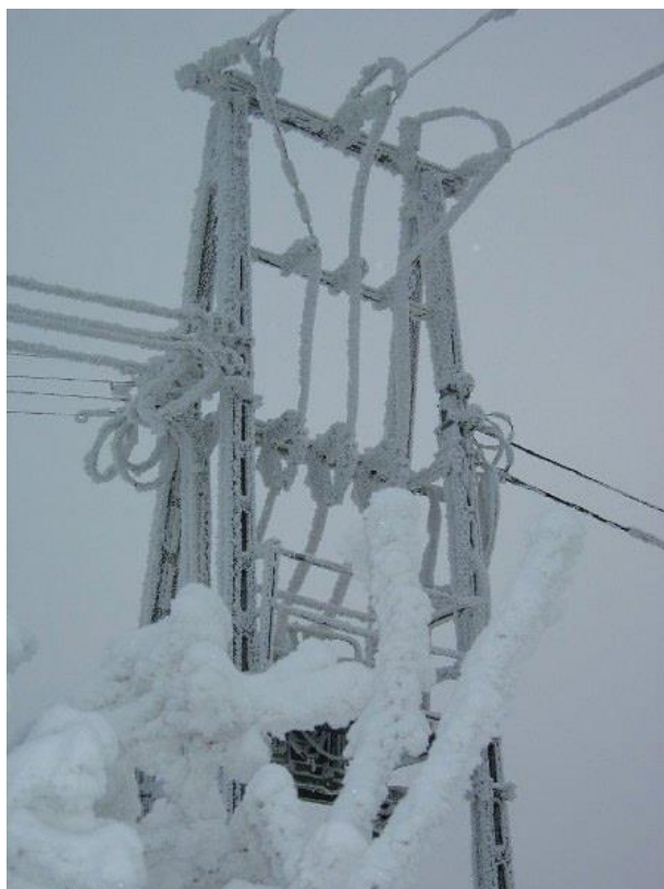
Oszronione urządzenia i przewody elektryczne
