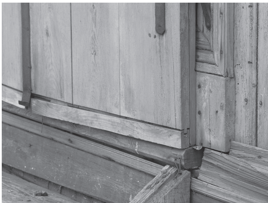
24. Warszawa-Wawer. Dawny pensjonat Batorówka, 1911 r. Okiennice w konstrukcji deskowej z listwami czołowymi. Fot. A. Cichy
