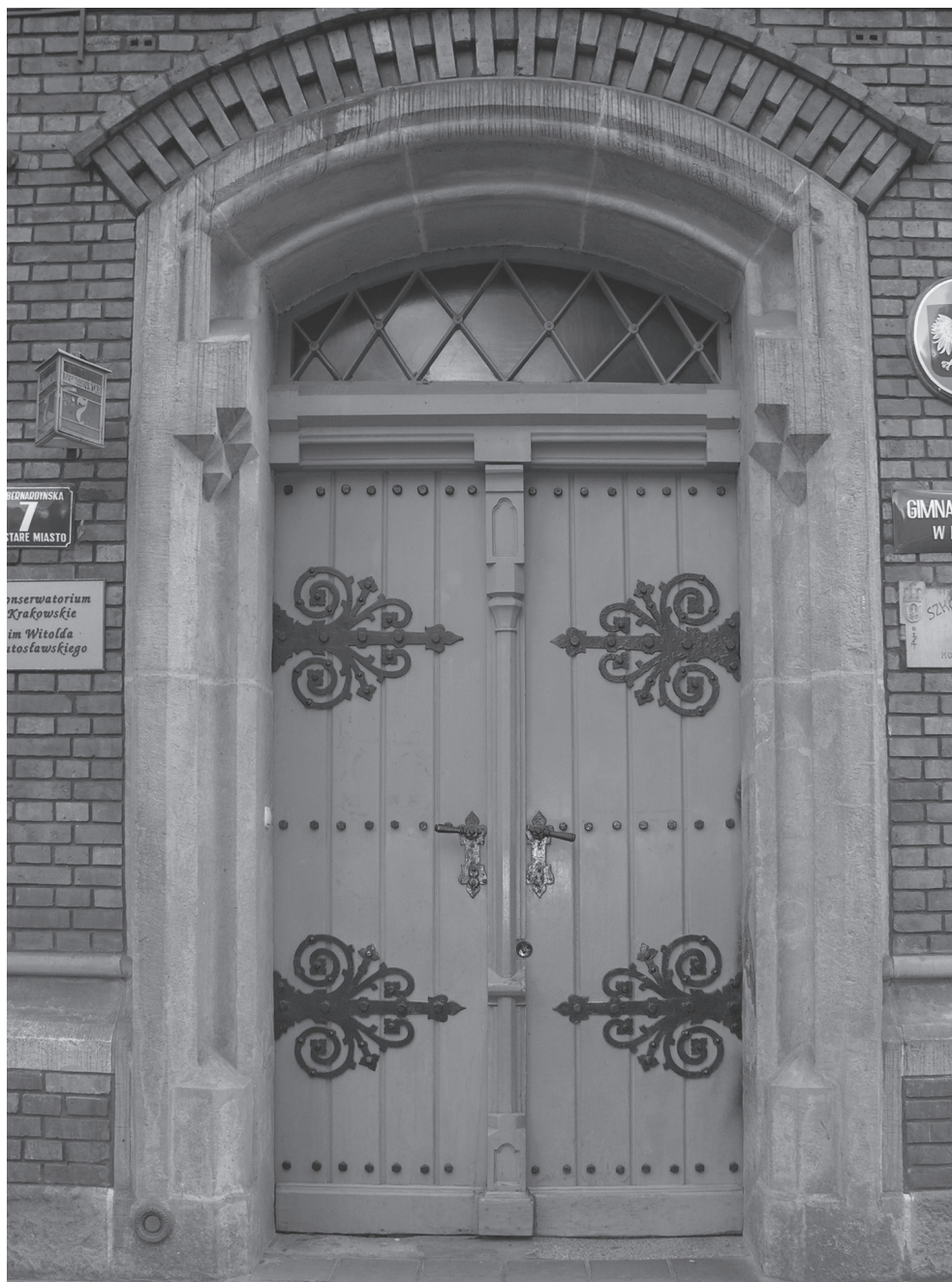
58. Kraków, ul. Bernardyńska 7. Neogotycki portal z drzwiami w konstrukcji ramowo-płycinowej z opięzieniem szalówkami awersu i ozdobnymi okuciami, 1878 r. Fot. A. Cichy
