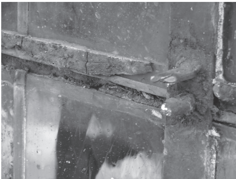
15. Zniszczone witraże przed demontażem. Fot. M. Czeski
