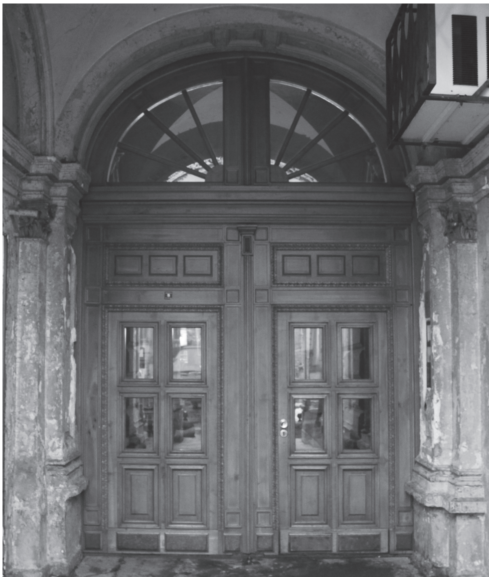
86. Przykłady wrót z kamienic warszawskich o różnym stopniu rekonstrukcji wykonanej na podstawie oryginalnych stolarek. A – Al. Ujazdowskie 18, B – ul. Wiejska 21. W drzwiach z Al. Ujazdowskich odtworzono wszystkie podzespoły, upraszczając konstrukcję poprzez wykonanie jej z jednego gatunku drewna (por. il. 32). W drzwiach z ul. Wiejskiej poddano renowacji tylko odrzwia i nadświetle (prace w toku), wymieniając skrzydła, którym (pomimo rozległych zniszczeń) można było przywrócić wartość użytkową. Błędem było również wykonanie skrzydeł jako konstrukcji w pełni przeszklonej (por. il. 31). W obu przypadkach zmieniono kolorystykę, odpowiednio: z malowania kryjącego na transparentne i z transparentnego na ciemny brąz. Fot. A. Cichy
