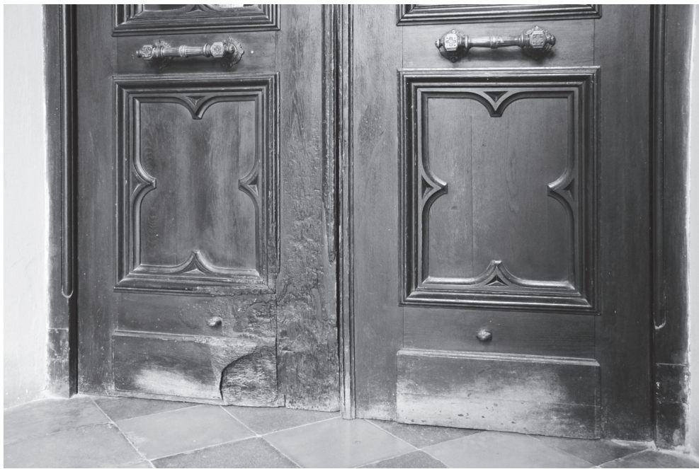
82. Warszawa. Kościół ewangelicko-reformowany, 1866-1880, proj. A. Löwe. Drzwi wewnętrzne ze śladami spalenizny pozostawionymi dla upamiętnienia tragicznych wydarzeń z okresu powstania warszawskiego. Fot. A. Cichy
