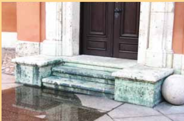
2. Przykład szkodliwego działania kwaśnych deszczy na elementy wykonane z miedzi
