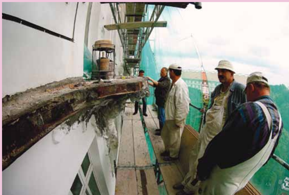
4. Zespół konserwatorski w trakcie dyskusji na temat technologii ratowania płyty balkonowej, wspartej na pięknie wyrzeźbionej w technice narzutu postaci uskrzydłonego geniusza
