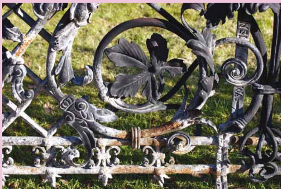
1. Rdza na elementach krat ogrodzenia pomnika Adama Mickiewicza w Warszawie
