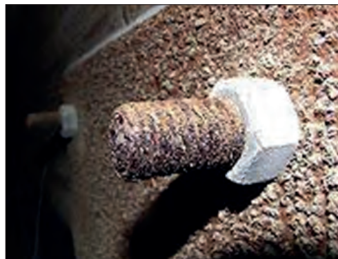
Atmosferyczna korozja kontaktowa Źródło: http://pl.wikipedia.org/wiki/Plik:RustBolt.JPG (autor: Thester11)
