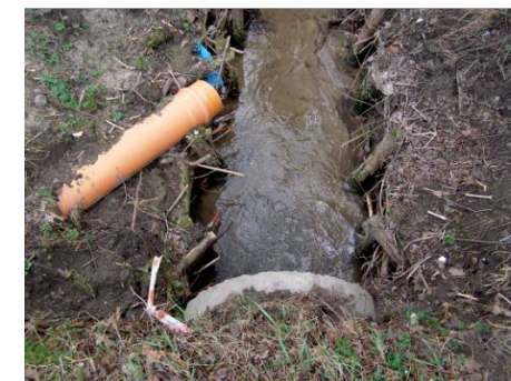
Ryc. 8. Odprowadzanie wody burzowej do ciek (Krzysztof Janku)
