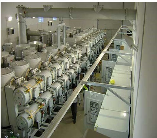
Nowa rozdzielnia 110 kV GIS
