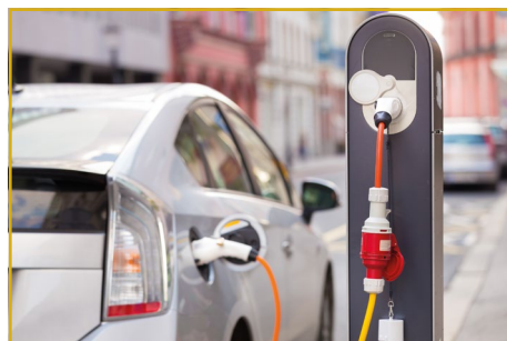
Rys. 5.7. Stacja ładowania samochodów elektrycznych.
