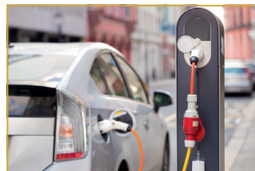
Rys. 5.7. Stacja ładowania samochodów elektrycznych.
