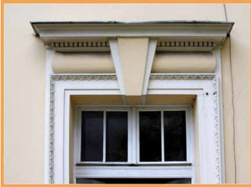
Skromnie, ale także elegancko w technikach sztukatorskich ozdobione obramienie okna w kamienicy przy alei Róż
