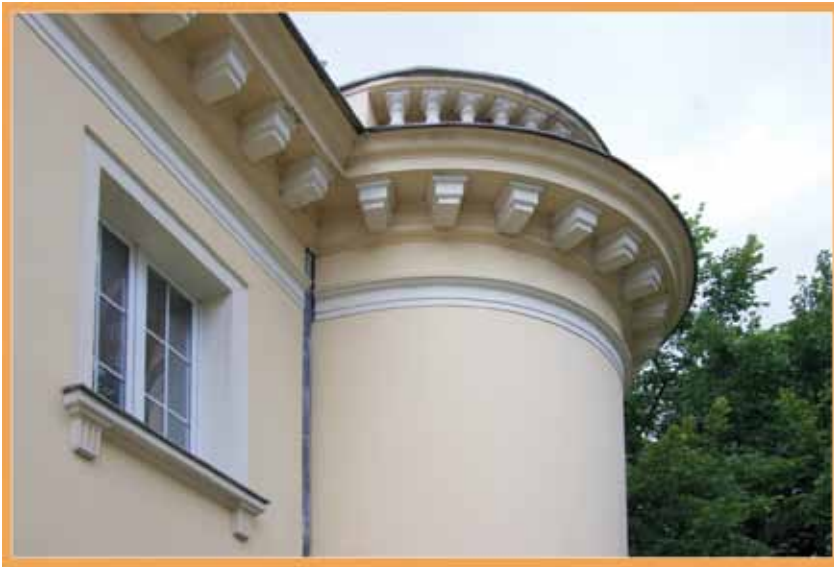
Wykonane w technologiach sztukatorskich elementy gzymsu koronującego i attyki w kamienicy przy alei Róż
