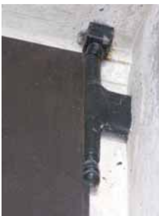
48. Warszawa, kościół Wszystkich Świętych. Drzwi ramowo-płycinowe z zawiasami i okuciami biegunowymi (wejście boczne lewe), l. 50. XX w. Fot. A. Cichy, 2014 r.
