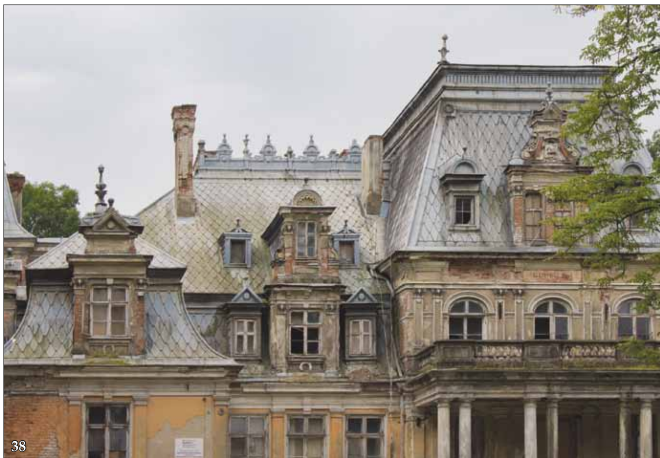
39- 40. Dekoracyjne grzebienie dachowe z blachy cynkowej. Stan z 2008 r. Fot. M. Krasucki
