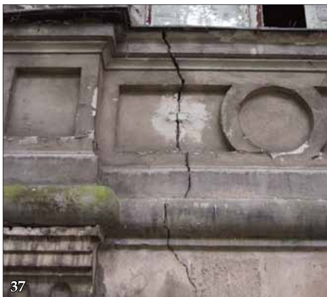
37. Monitoring spękań na elewacji wschodniej. Stan z 2011 r. Fot. M. Krasucki
